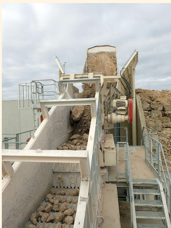
Alimentation de la trémie primaire par un tombereau rigide (Cat 772). Ce poste est constitué de matériels de la société August Müller avec la trémie (50 m 3 ), l'ATM et le scalpeur à disques servant à éliminer du flux la fraction argileuse du tout-venant.
